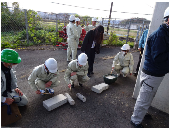
コンクリート調査 (空洞のある不良コンクリート塊の打音調査)
