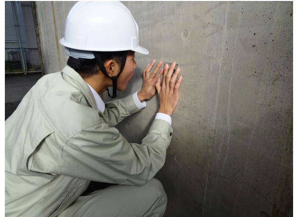
コンクリート調査 (クラックスケールによるひび割れ幅測定)
