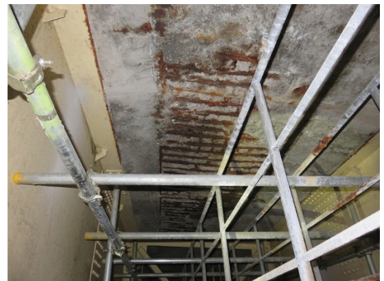
床版下面・鉄筋露出
